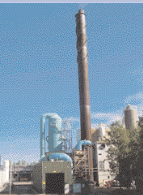
I ADIOX-tekniken spelar inblandningen av kol en viktig roll. Kolet binder nämligen dioxinet.
