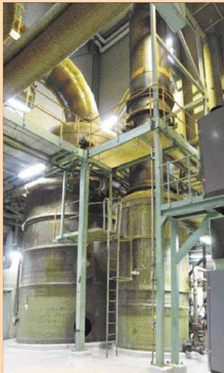
Befintlig skrubberinstallation på Renova. Det nya systemet är effektivare och avskiljer mer svavel.
