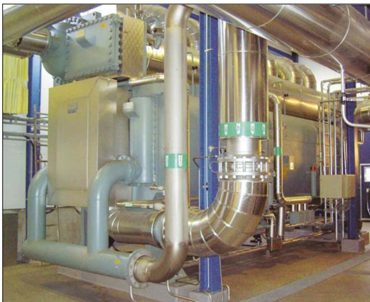
Absorptionsvärmepumpen på plats. Installationen har överträffat Karlstads Energis förväntningar.
