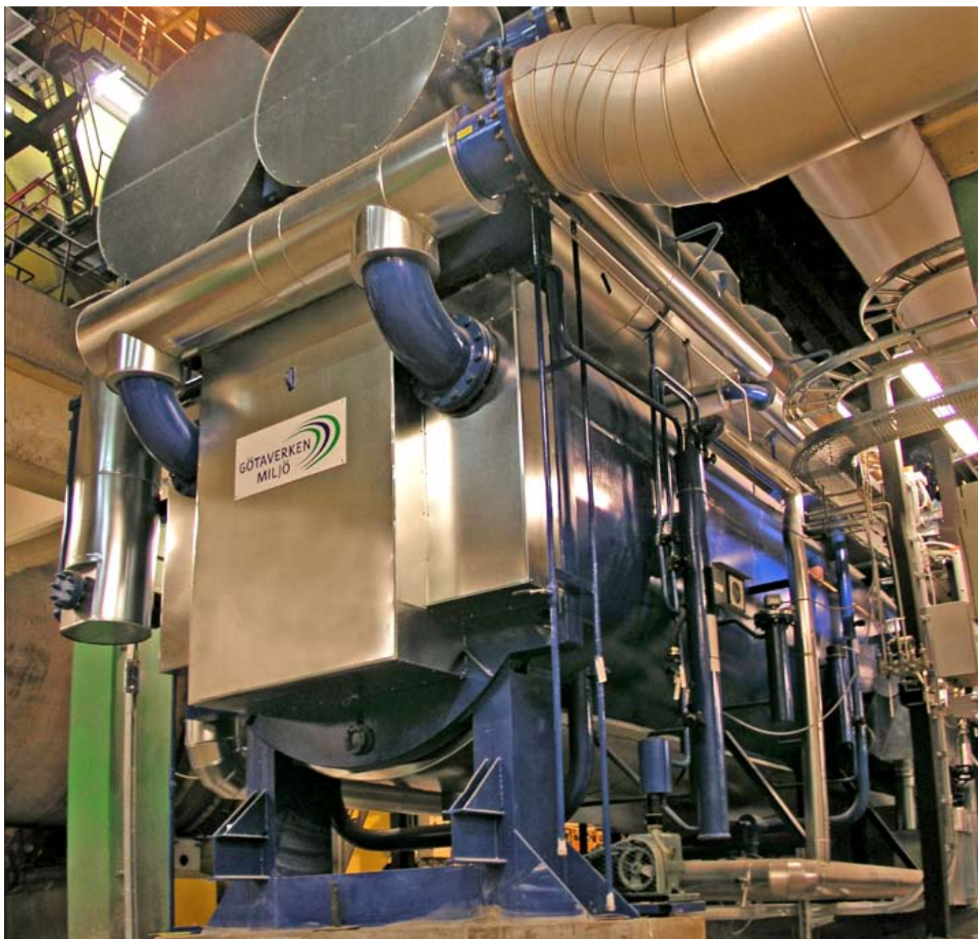
Absorptionsvärmepump, I/S Vestforbrænding i Köpenhamn.
