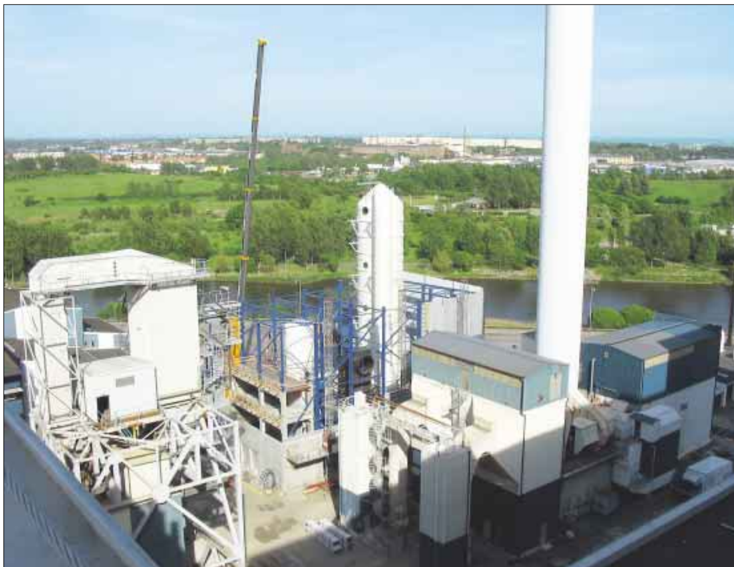
Sysav i Malmö moderniserar just nu avfallsvärmeverkets linjer 1 och 2. Bland annat för att klara de nya EU-direktiven rörande utsläpp till luft.
