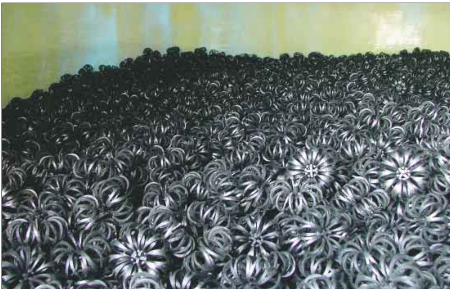
Adiox-fyllkropparna förbättrar kontakten mellan rökgasen och processvätskan.
