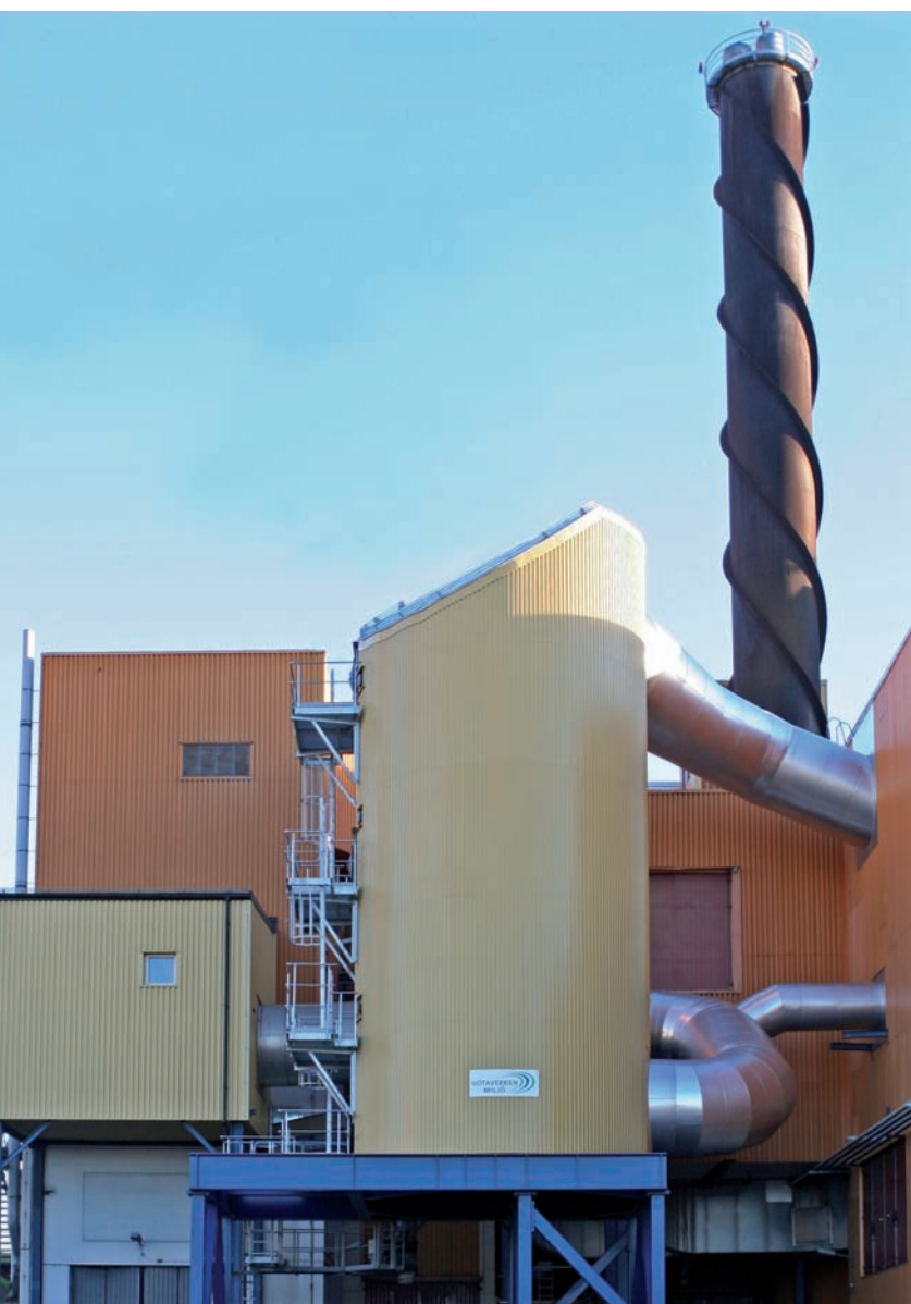
L'absorbeur sec ADIOX®, usine de Gärsstadverket.
